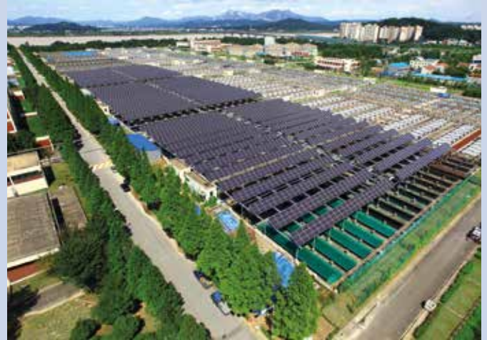
Fig. 2 - 3,6 MW PV power plant, Seoul, Korea.
