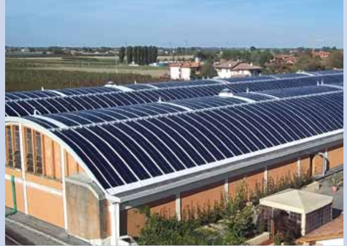
Fig. 2 - 123 kWp PV plant at Argenta (FE), using DERBISOLAR flexible modules (thin film on flexible support) (Photo: GSE, Gestore del Sistema Elettrico).
