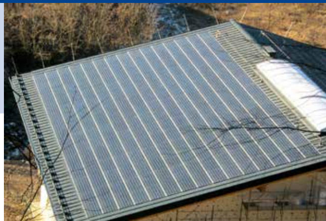
Fig. 2 - 101 kWp PV plant at Fornace (TN), Monocrystalline modules (Photo: GSE, Gestore dei Servizi Energetici).
