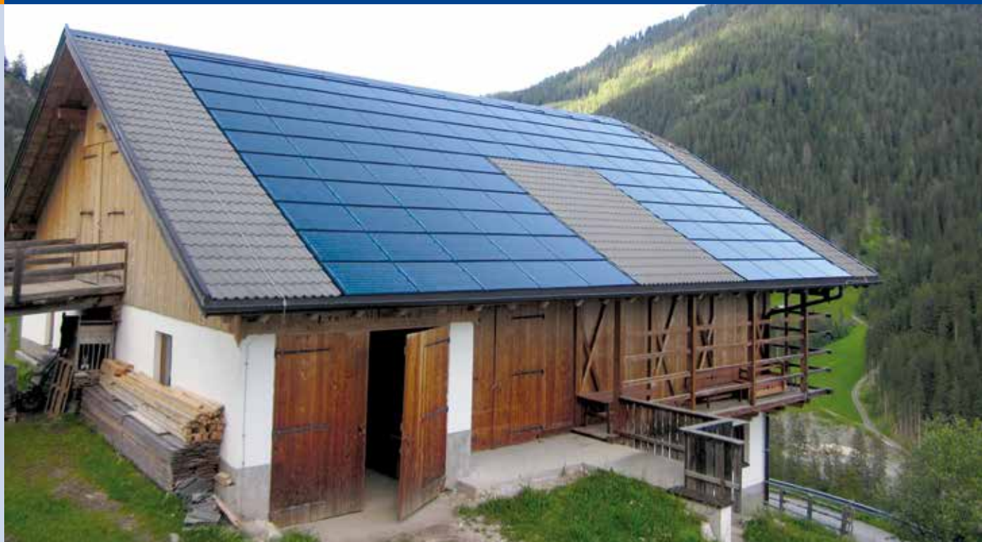
Fig. 3 - 20 kWp PV plant at Badia (BZ), Monocrystalline modules (Photo: GSE, Gestore dei Servizi Energetici).
